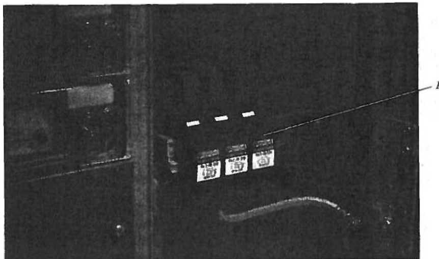
Рис. 5.26. Установка разрядника с газовым выбросом в распределительном
